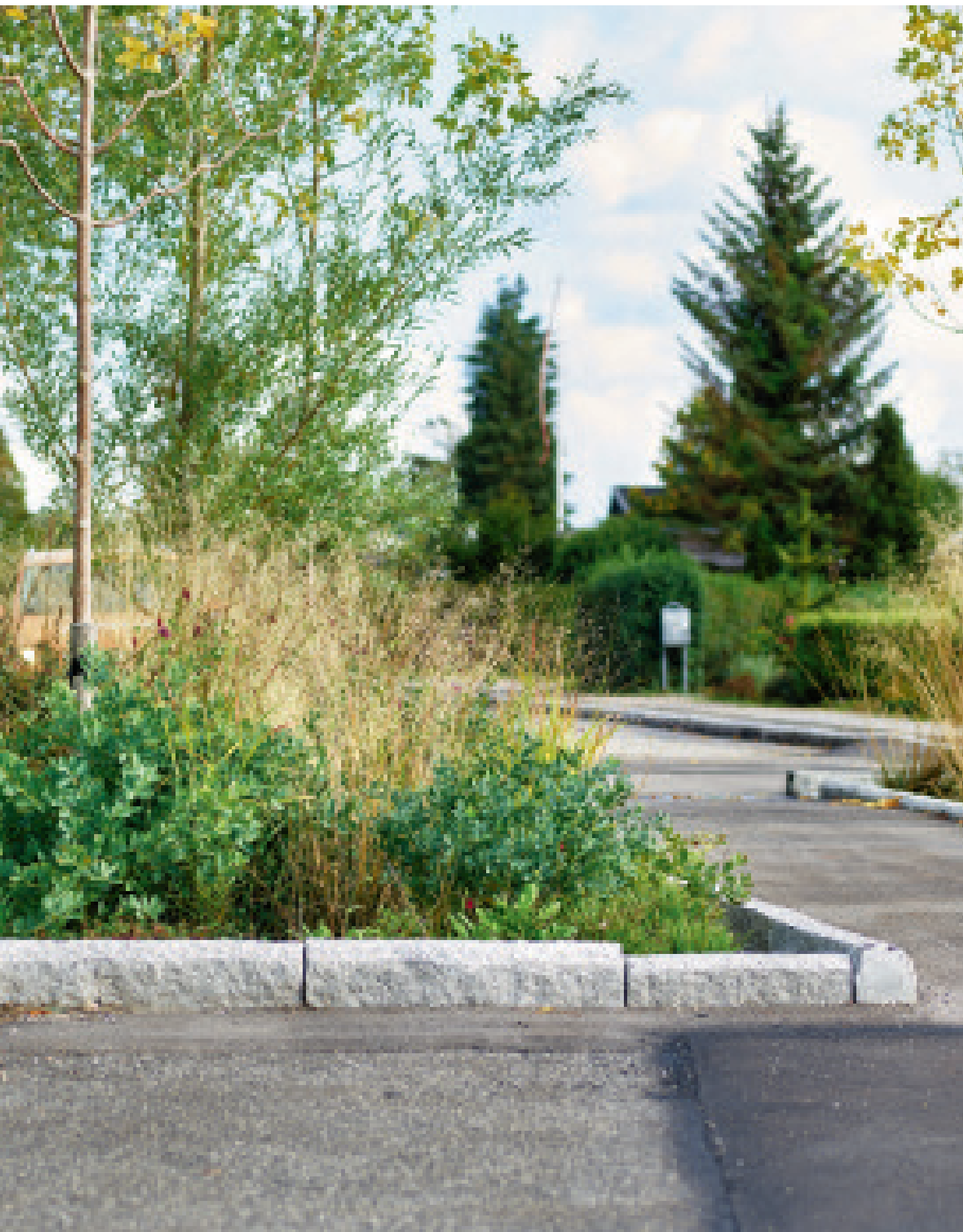
Sænket bedkant for styret overløb.
