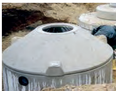
Runde prefabrikkerte tanker
